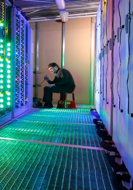
Die Infrastruktur für das KI-Innovationslabor wird am Green IT Cube des GSI Helmholtzzentrums für Schwerionenforschung in Darmstadt angesiedelt.
